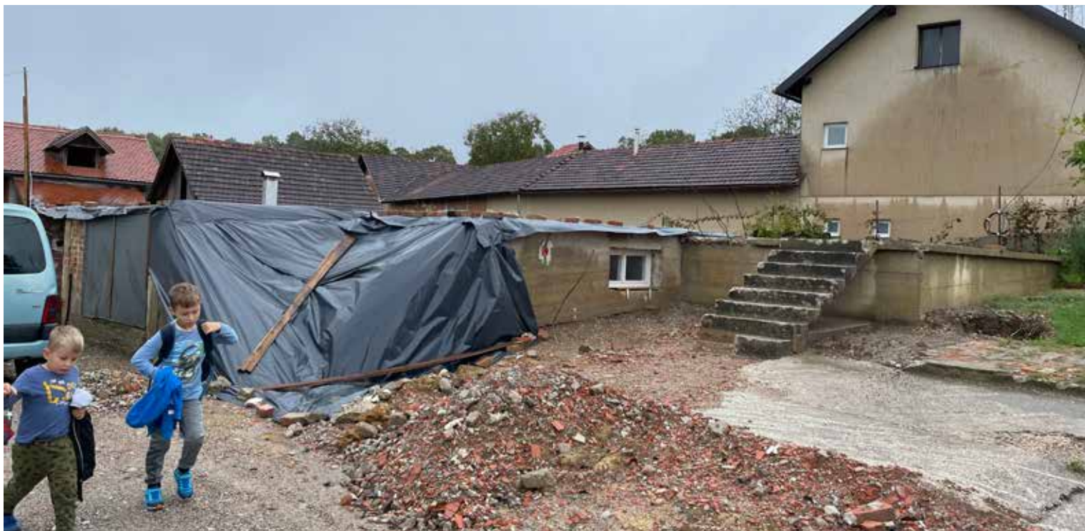
Das Haus einer der Familien wurde nach den Beschädigungen durch das Erdbeben nun vollständig abgebrochen, nun wird auf die staatliche Unterstützung für den Wiederaufbau gewartet
